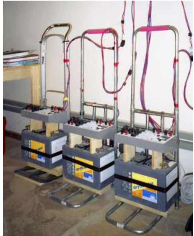
Abb. II.22 Wanderbatterien an der Ladestation
