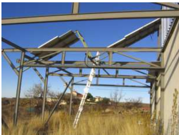
Abb. II.18 Installierte Solarmodule am Hauptgebäude
