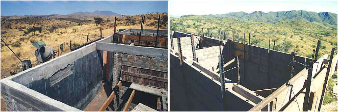
Abb. II.5 Der alle Mauern umschließende Ringanker ist beinahe fertig gestellt. Im Hintergrund sind der Gamsberg (links) und die Hakosberge (rechts) zu sehen
