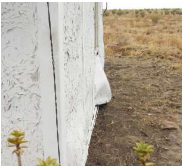
Abb. II.65 Zerfallende Außenwände an den Wohngebäuden
