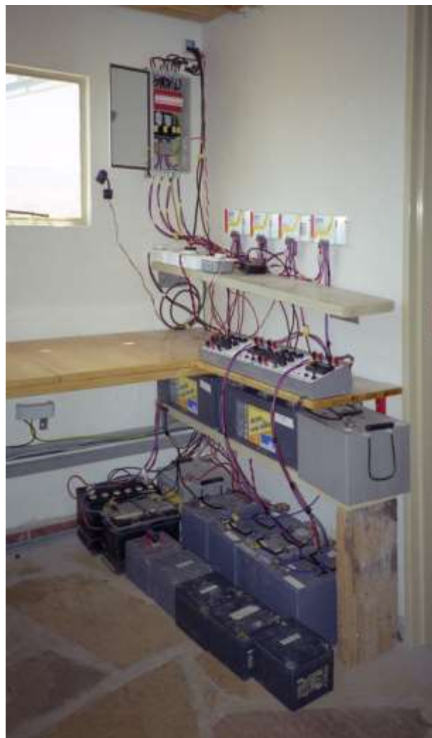
Abb. II.19 Gesamtanordnung im Computerraum mit Anschlusskasten, Solarreglern und Batteriesatz
