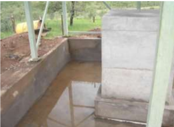
Abb. II.58 Ein erster Regenguss verwandelt den frisch betonierten Untergrund in ein Schwimmbad
